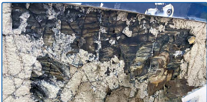
Under det yttre skalet fanns ett lager med polyesterspackel och sedan ca 30 mm plywood. Med en tryckluftsmejsl gick arbetet relativt enkelt.
